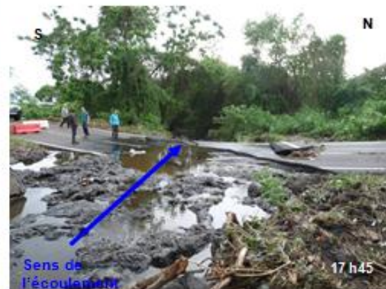
2 : Destruction du radier et laisses de crue
