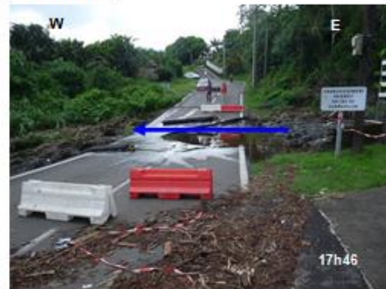
1 : Destruction du radier et laisses de crue
