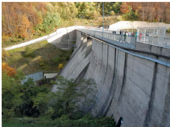
Mission post-sismique suite au séisme du 24 août 2016 en Italie centrale (Amatrice). Barrage poids en béton de la retenue de Scandarella (Italie, octobre 2016). © BRGM - Nicolas Taillefer
