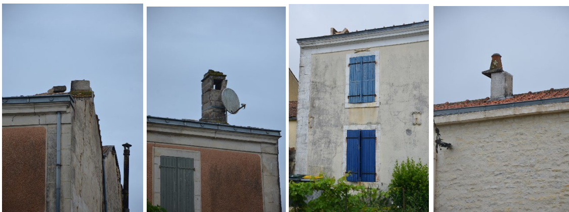
Figure 10 : Ces photos (©BRGM-JC Audru, photos 4361 -4362 -4417 -4454) illustrent les dommages observés sur la commune de Cram-Chaban et La Laigne. Dommages aux éléments de toitures et aux cheminées.
