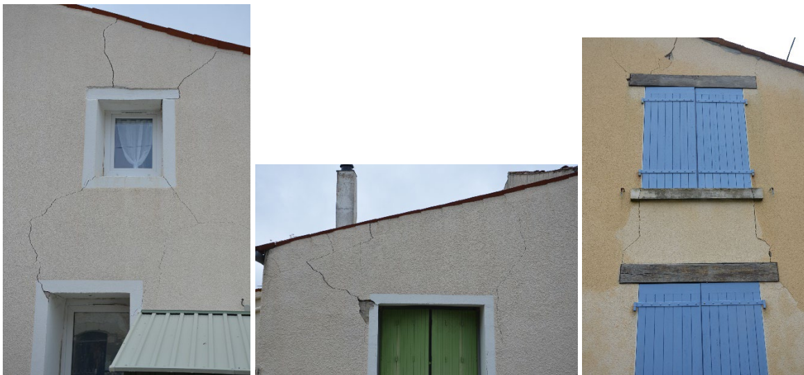
Figure 7 : Ces trois photos (©BRGM-JC Audru, photos 4432 – 4435 - 4440) illustrent les dommages observés sur la commune de La Laigne, à savoir des fissurations dans la maçonnerie enclenchées par des concentrations de contraintes aux angles dans des maisons individuelles en maçonnerie.
