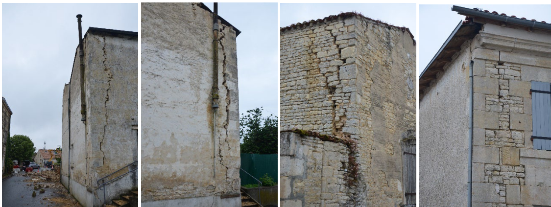
Figure 9 : Ces photos (©BRGM-JC Audru, photos 4368 -4366- 4381- 4395) illustrent les dommages observés sur la commune de Cram-Chaban. Il s'agit de dommages liés à la désolidarisation de l'angle de murs en maçonnerie, par absence ou mauvaise connexion aux murs orthogonaux.
