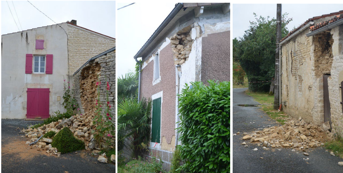
Figure 6 : Ces trois photos (©BRGM-JC Audru, photos 4429 – 4461 – 4483) illustrent les dommages observés sur la commune de La Laigne. Gauche : Chute d'une partie du mur sans effondrement du toit. Centre : Défaillance d'angle en haut du mur en maçonnerie en pierres. Droite : défaillance de la partie supérieure du mur.
