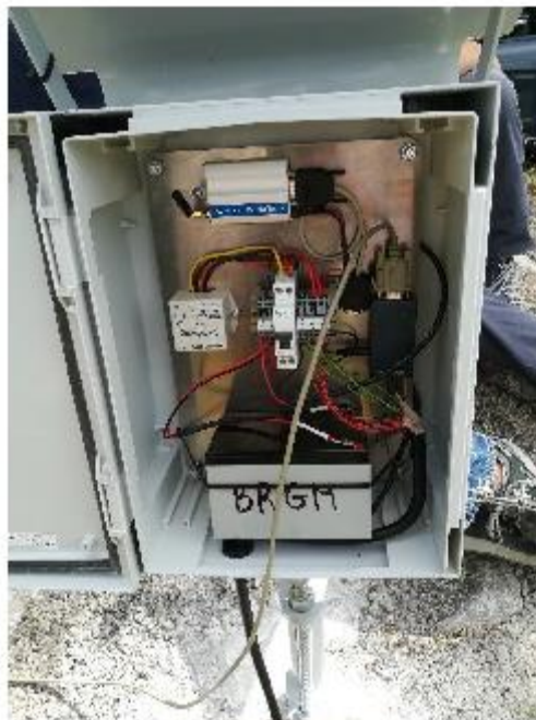
Figure 6 Coffret temps réel
