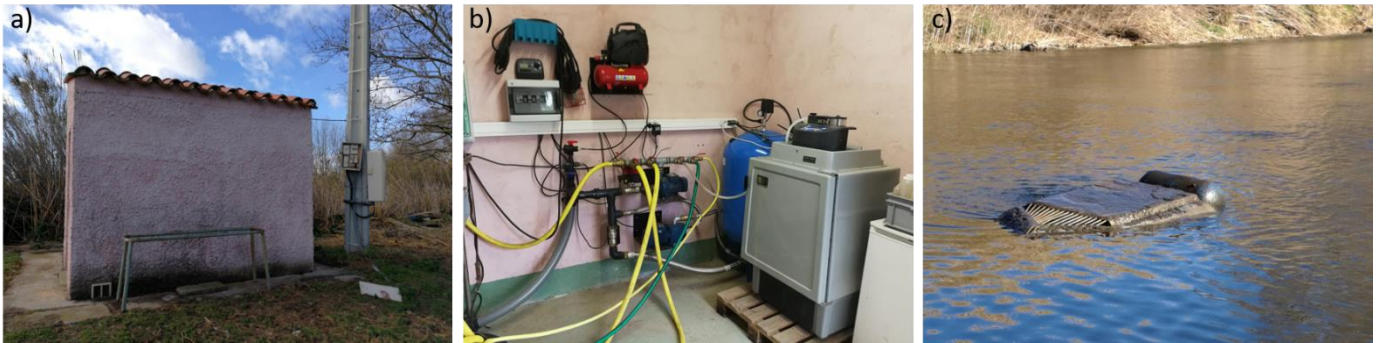
Figure 5 : Station de mesure de Villelongue-de-la-Salanque. a) Station de mesure. b) Système de pompage avec préleveur Teledyne ISCO 6712FR. c) Radeau.
