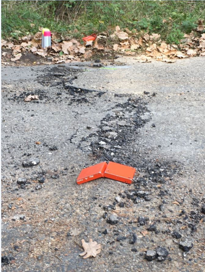
Première observation de rupture des terrains observée le long de la discontinuité inSAR par J.F. Ritz, S. Baize, C. Larroque, M. Ferry (mission postsismique RESIF, le 13/11/2019) : bourrelets compressifs dans le goudron de la route. Petite composante senestre possible.
