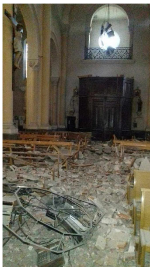
Effondrement du plafond de l'évêché du Teil (d'après France Bleu Ardèche)
