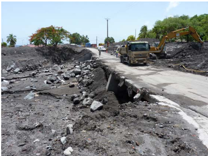
Dégâts provoqués par les lahars sur l'ouvrage de franchissement du Prêcheur
