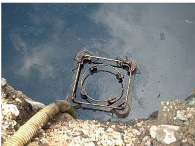
Système de pompage par écrémage des hydrocarbures
