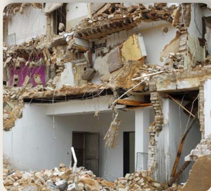
Dégâts causés par un séisme en Guadeloupe et dans ses îles
