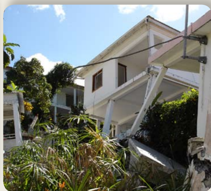
Dégâts causés par un tremblement de terre en Guadeloupe et dans ses îles
